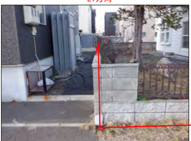
④ E2~E1境界線を跨いで本地ブロック塀がある。 E1方向
