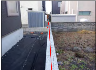
② E1~E5境界線を跨いで本地ブロック塀がある。 E1方向
