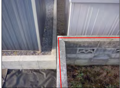
① E1~E5境界線を跨いで本地ブロック塀がある。
