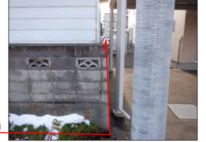
⑦ E5~E1境界線を跨いで本地ブロック塀がある。 E1方向
